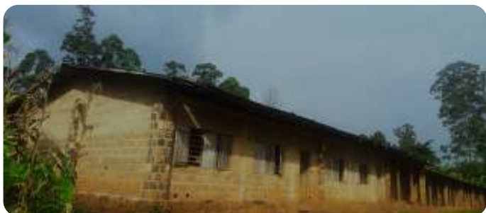
Vóór de renovatie: aftandse luiken voor de ramen, geen deuren, slecht dak.
